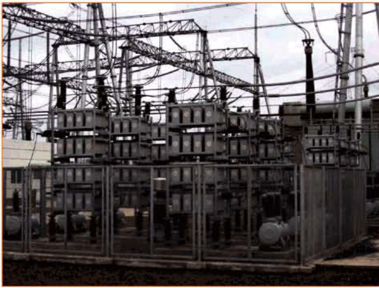
国家电网, 500kV 变电站 并补 (四川)
