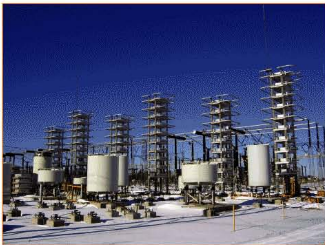
丹麦 KONTISKAN 直流输电 HVDC 项目 (2004年)
