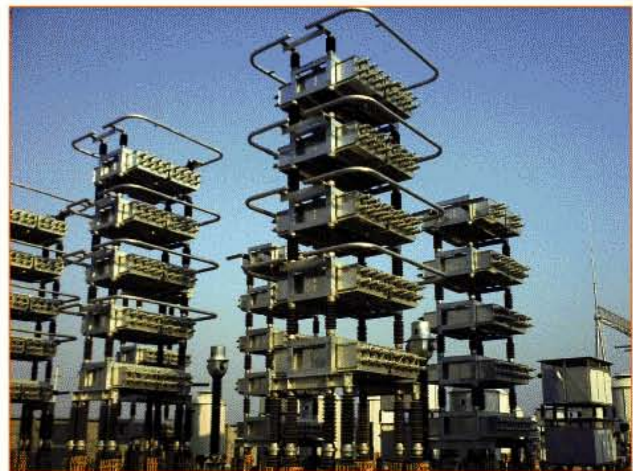
中国 南方电网±800kV云广直流输电 HVDC 项目穗东变电站 (2008年)
