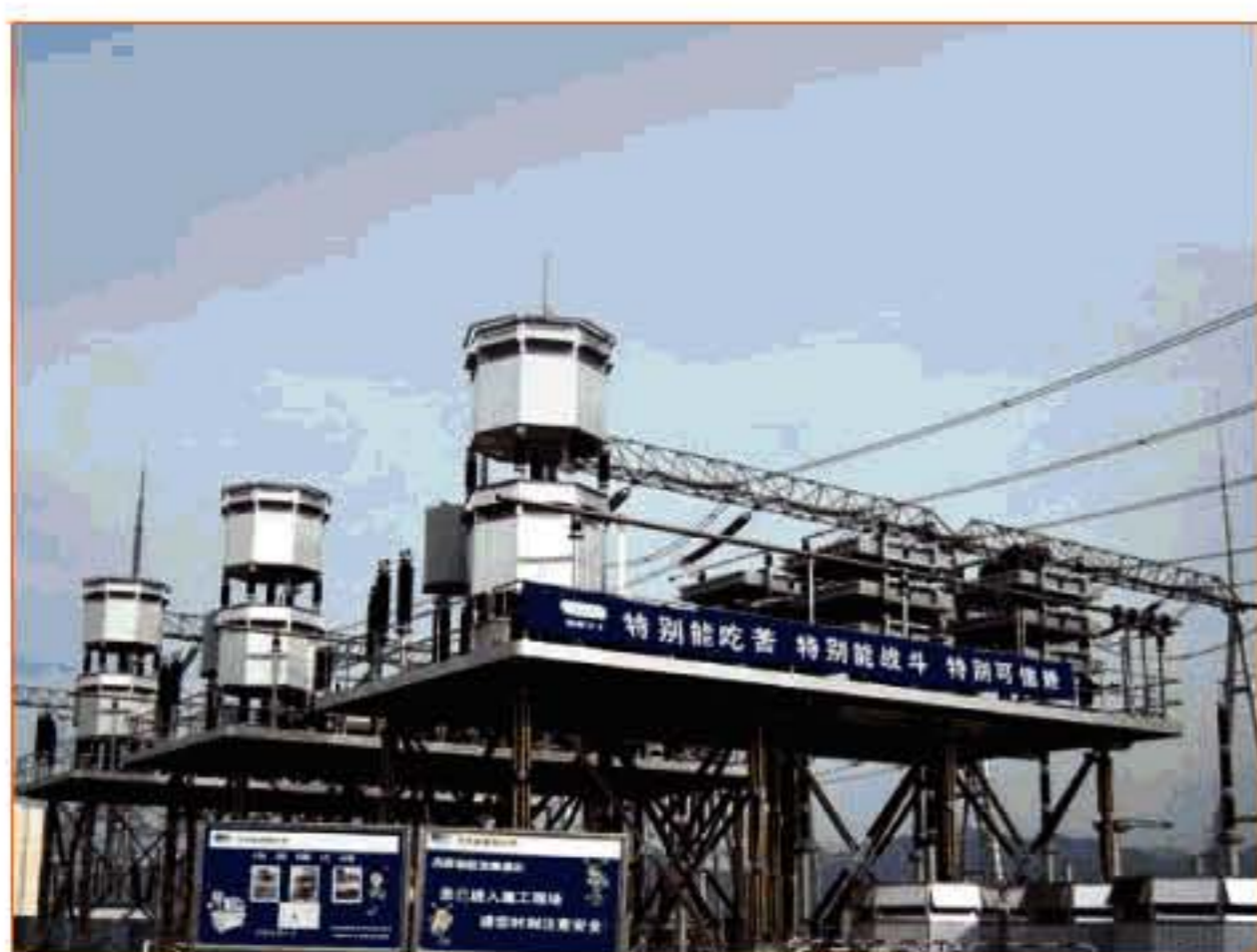
国家电网 ±500kV 浑源串补 (山西, 2007年)
